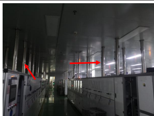
叠层车间浸工聚合废气收集管道
