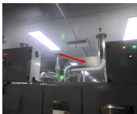
固液电容器车间浸工聚合废气收集管道
