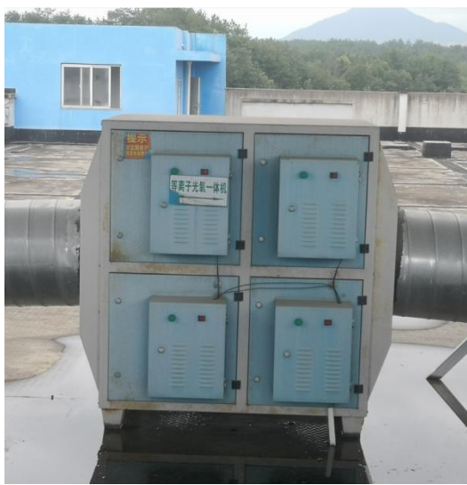
2#废气处理设施（等离子）
