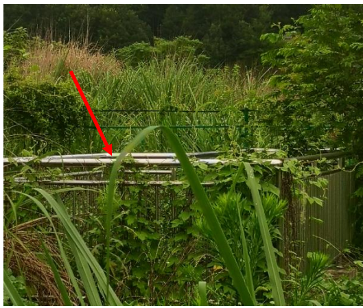
污水处理站出水口
