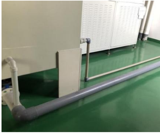
车间内部废水排水管道
