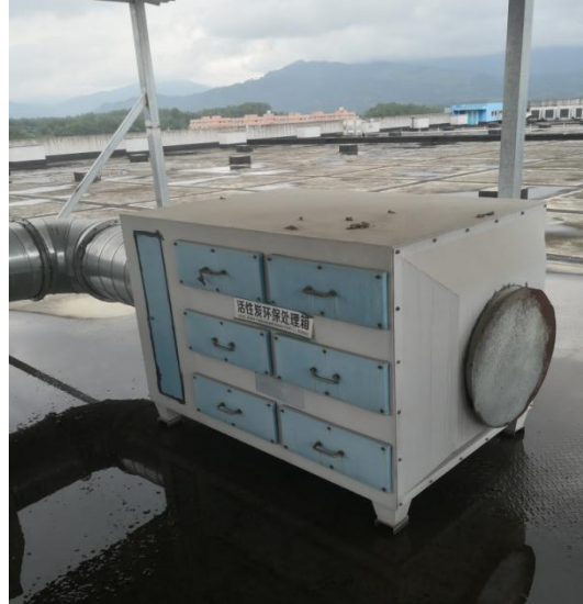
2#废气处理设施（活性炭吸附箱）
