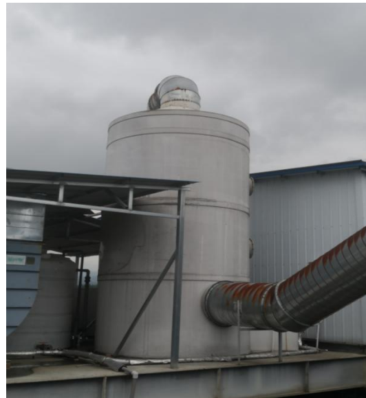
2#废气处理设施喷淋塔
