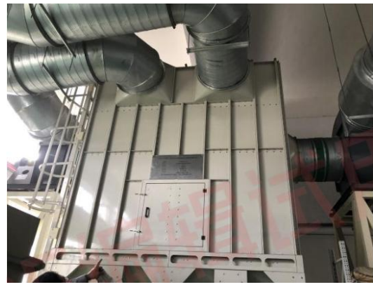
切箔车间粉尘除尘器
