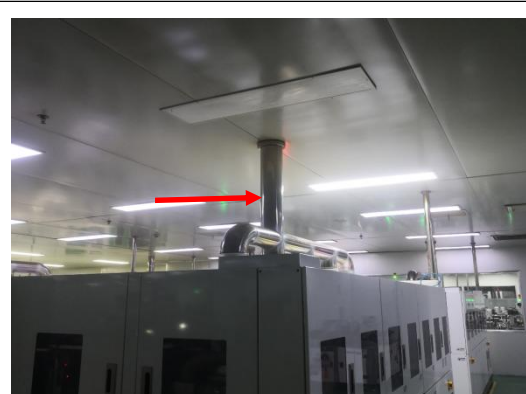
叠层车间化成废气收集管道
