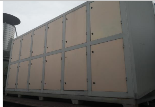
1#废气处理设施（活性炭吸附箱）
