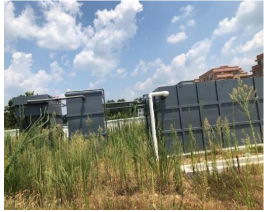
污水处理一体化设施
