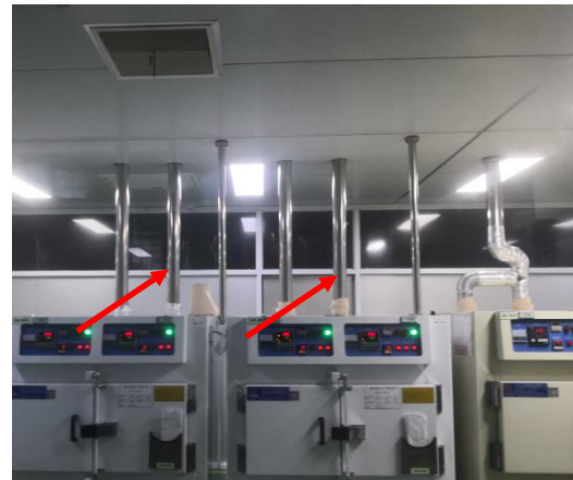
固液电容器车间化成废气收集管道
